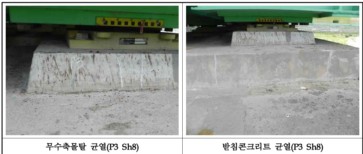
【사진 3.2.13】 교량받침 손상현황(대구)
