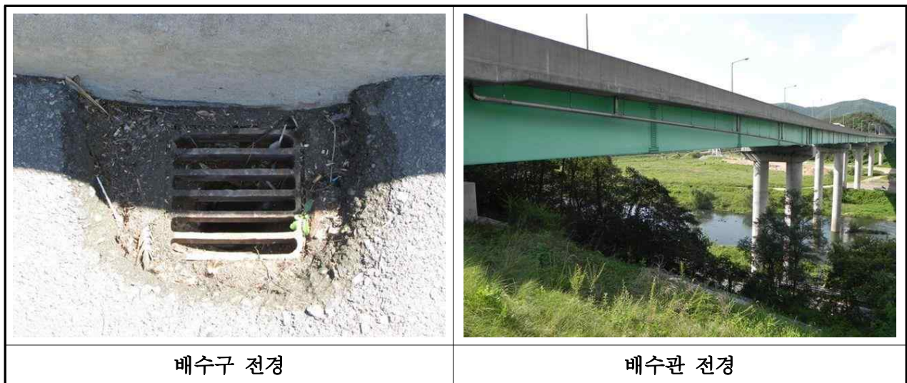
【사진 3.3.20】 배수구 및 배수관 전경(부산)
