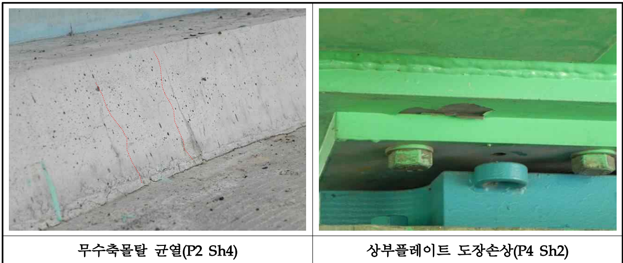
【사진 3.3.13】 교량받침 손상현황(부산)
