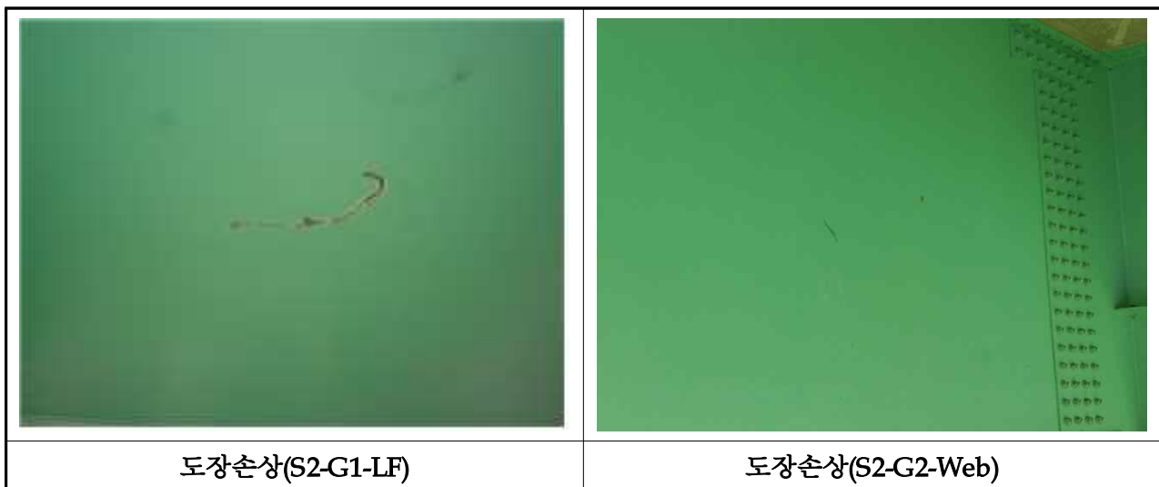
【사진 3.3.5】 강박스 거더 외부 손상현황(부산)
