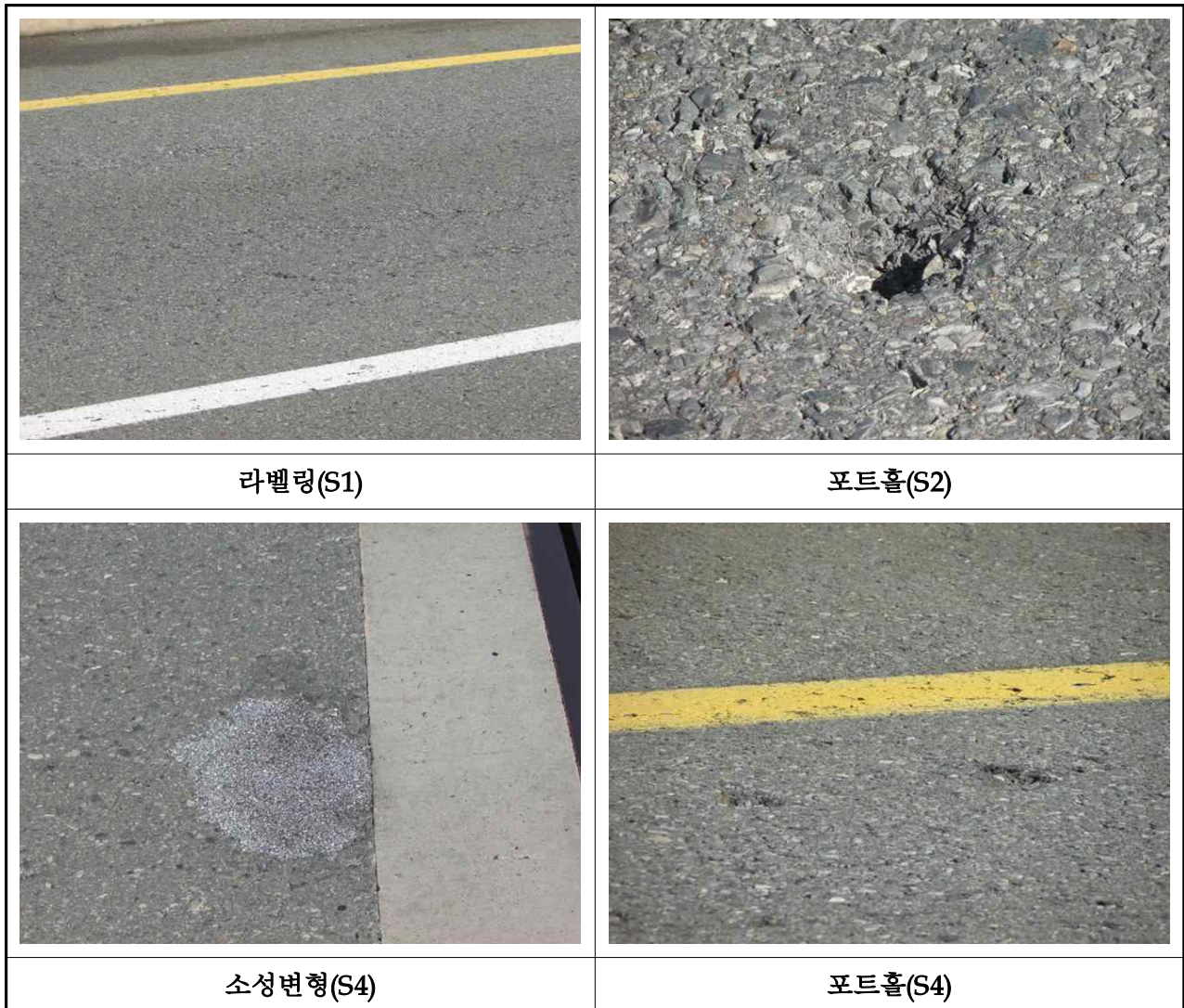
【사진 3.3.19】 교면포장 손상현황(부산)
