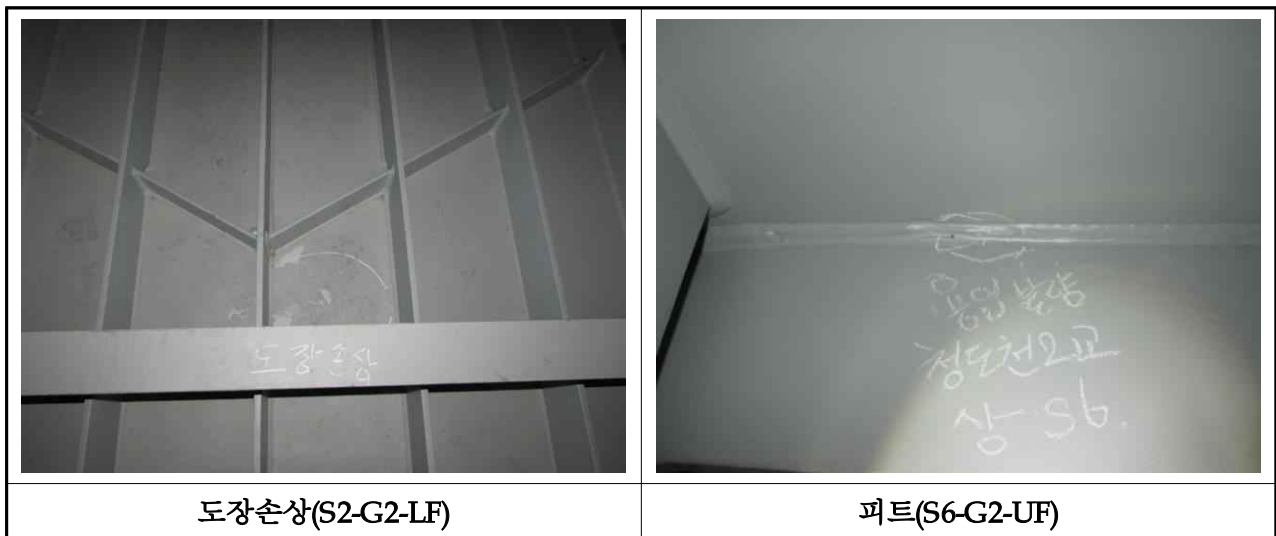
【사진 3.2.4】 강박스 거더 내부 손상현황(대구)
