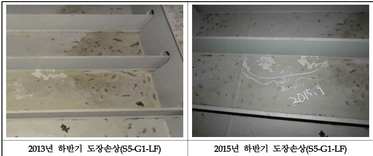
【사진 3.3.4】 강박스 거더 내부 손상현황(부산)
