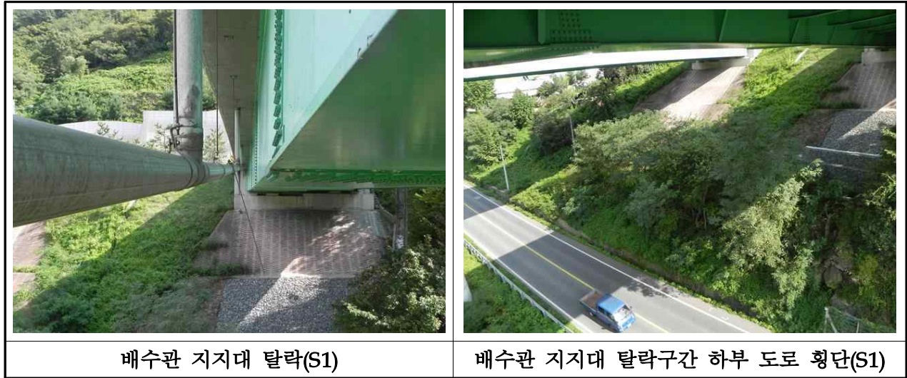
【사진 3.3.21】 배수시설 손상현황(부산)
